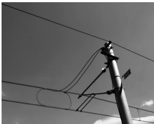
图 1-11 轨道交通架空柔性接触网
