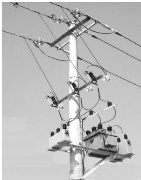
图 1-18 企业变电所的室外下线部分
