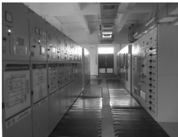
图 1-17 企业变电所的室内部分
