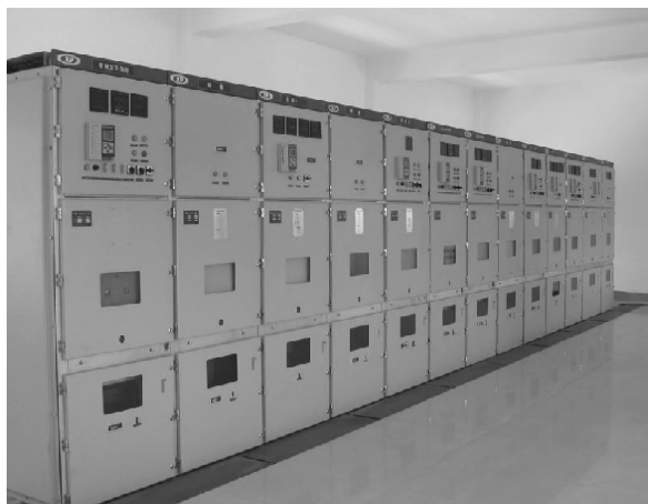
图 1-16 高压配电所室内部分
