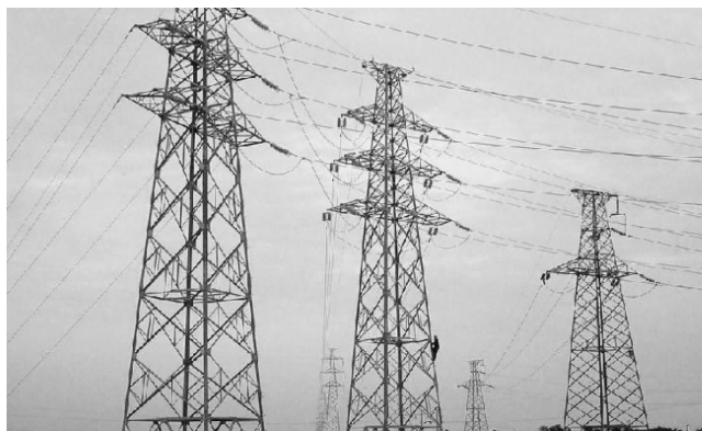
图 1-13 高压送电线路
