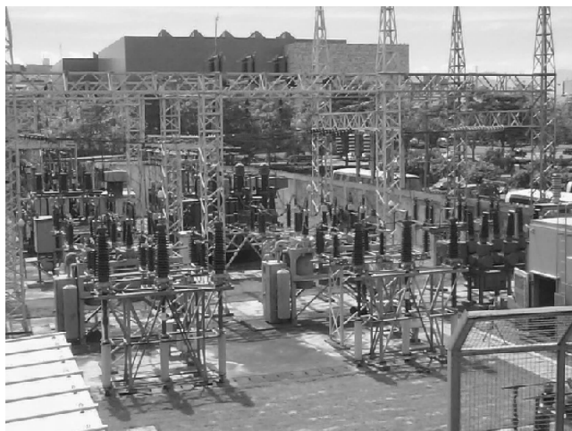
图 1-14 总降压变电所
