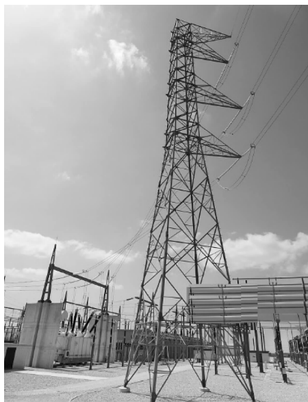
图 1-15 高压配电所室外部分
