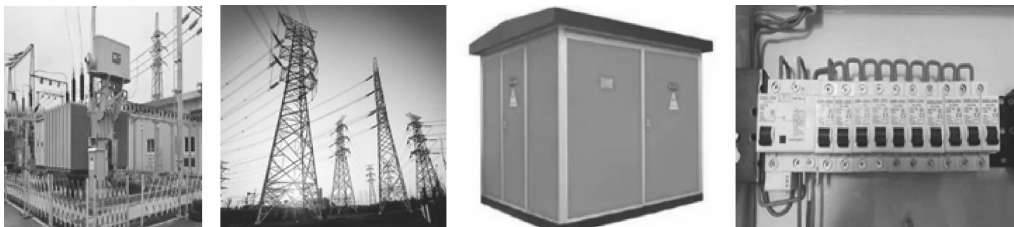
图 1-5 变压器、输电线、变配电所和配电箱
