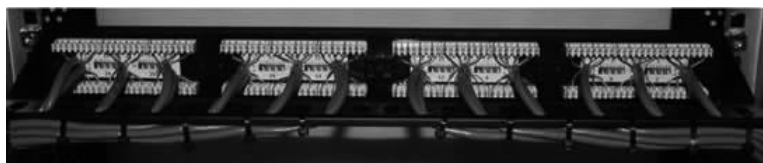
图 1-13 双绞线配线架反面实物图
