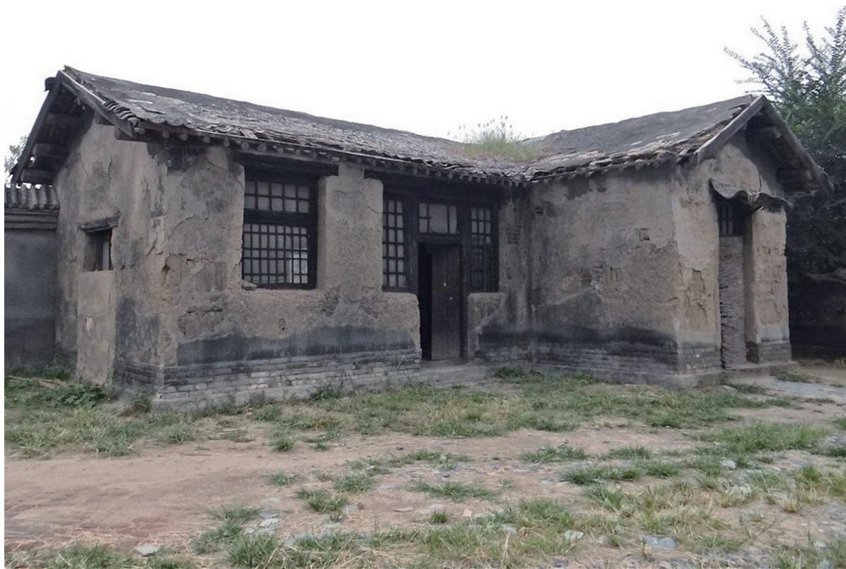
图 1-7 破旧房屋照片素材
